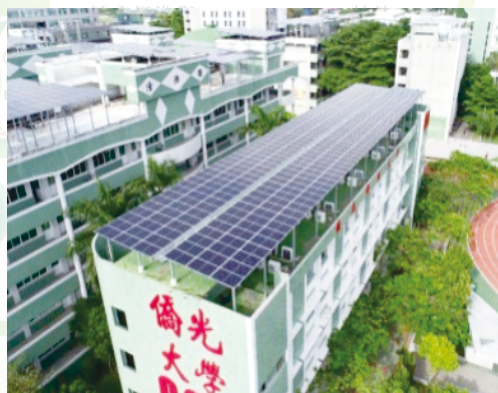
校園頂樓太陽能發電
